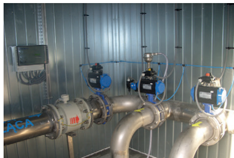
Stacja osłonowa w Kamionnej
